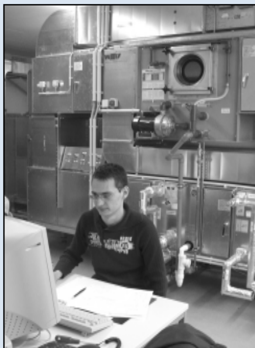
Elektrotechnikstudent Christian Peppe ist einer von zwei Diplomanden, die am Projekt mitarbeiten. Im Hintergrund die über einen Großgeräteantrag im Jahr 2006 beschaffte Klimaanlage.
